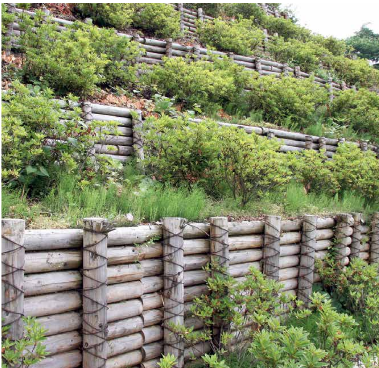
D-0003 土留め柵
